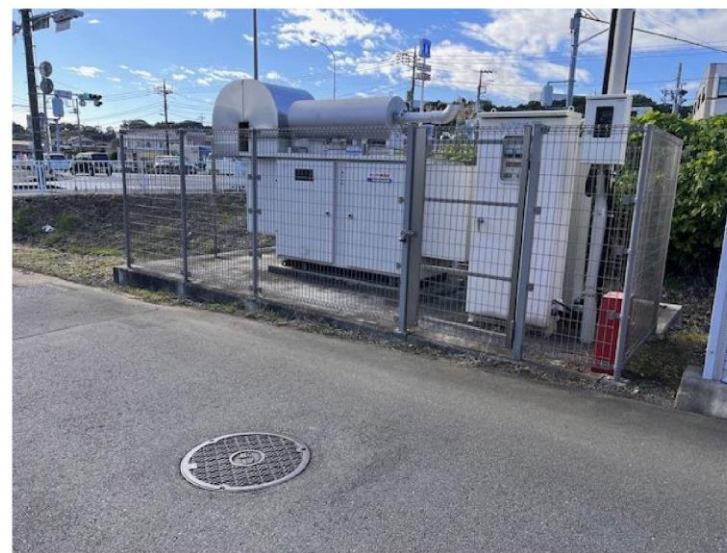
操作盤・配電盤及び自家発電施設
