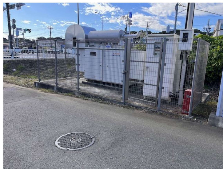
操作盤・配電盤及び自家発電施設
