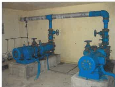
第5水源揚水場（汲み上げた地下水は浄水後、ご利用のお客様のご家庭へ送られます）
