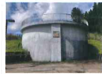
須山配水場 800m 3
