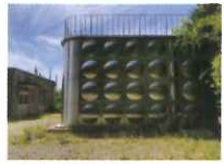
千福配水場 660m 3
