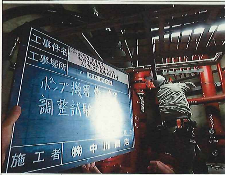
ポンプ機器警報復元措置 ポンプ運転作業
