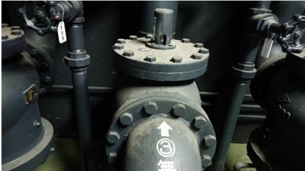
一斉開放弁③正面より
