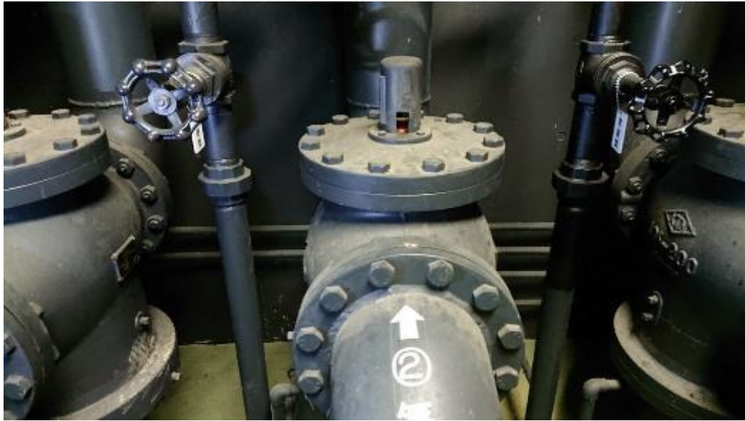
一斉開放弁②正面より
