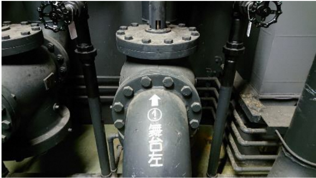
カ 一斉開放弁の開閉の状況（令和4年9月24日の事故直後に撮影） 一斉開放弁①正面より
