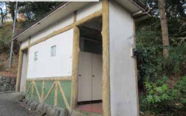
老朽化により修繕が必要なトイレ
