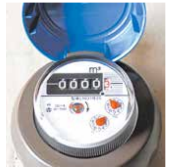
水道メーター
