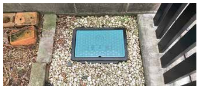
水道メーターボックス
