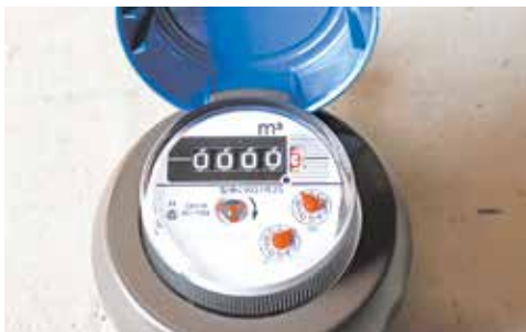
水道メーター
