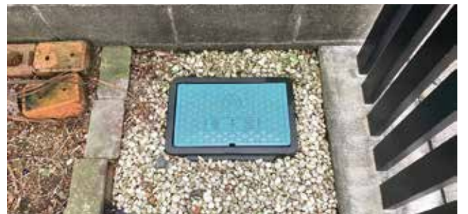
水道メーターボックス
