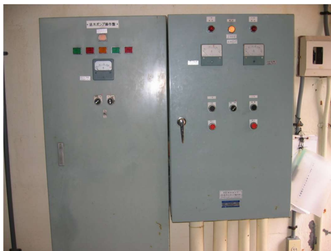
第5水源揚水場（取水から配水まで一連の工程を自動運転で行っています）
