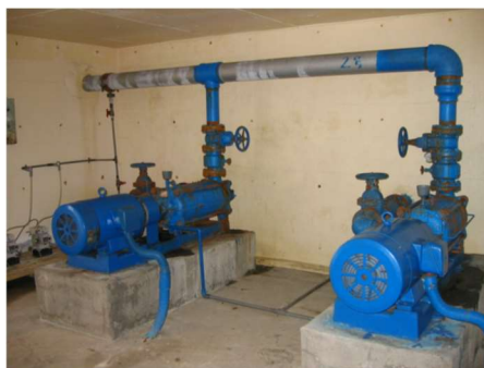
第5水源揚水場（汲み上げた地下水は浄水後、ご利用のお客様のご家庭へ送られます）
