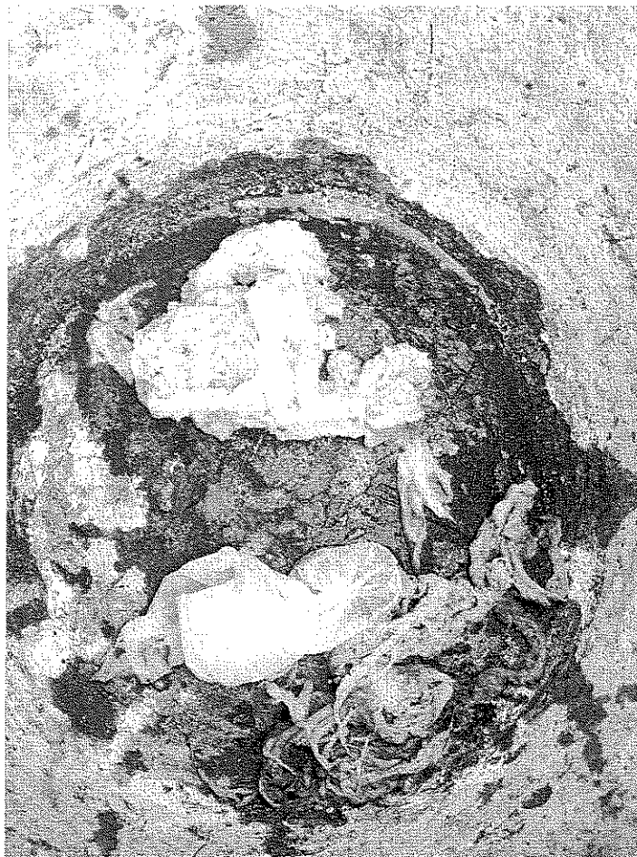
今回マンホールポンプに付着した異物
