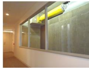
オイルダンパー（5 基）
