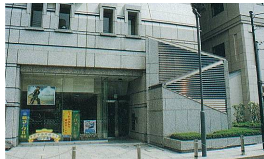
換気口を外壁と一体的にデザインし、目立たなくさせている。
