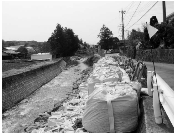
昨年の台風による被害箇所（市の瀬地先）
