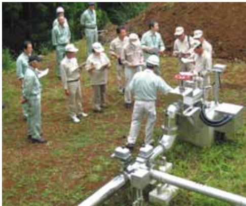
取水ポンプ場（千福が丘）
