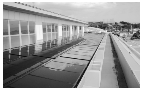
南小学校の太陽光パネル
