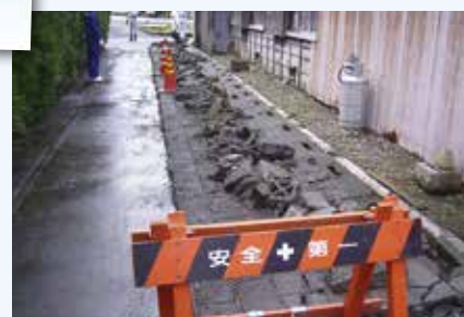
ブロック塀 の倒壊▶
