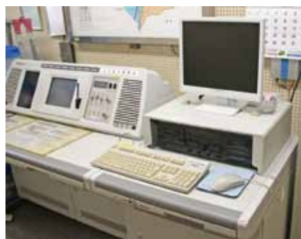
◀ 東富士演習場無線放送施設設置助成事業 (デジタル施設に更新する防災行政無線放送施設)
